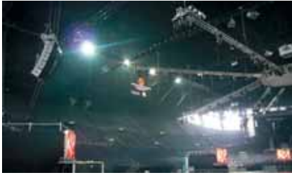
Das Züricher Hallenstadion mit der PA aus DYNACORD V-Systems-Lautsprechern sowie DYNACORD H5000 und Electro-Voice TG7-Endstufen
